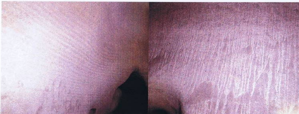
壁の水平な縞模様は、水面の痕跡。縦筋は、泥が壁に沿って流れた痕跡。
